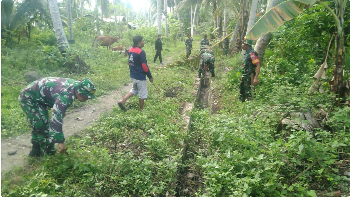
Kerja bakti pembersihan saluran drainase tersebut digelar di desa Banatorejo, Kecamatan Tapango, Kabupaten Polewali Mandar, Sulawesi Barat. Rabu (20/3/2024).
